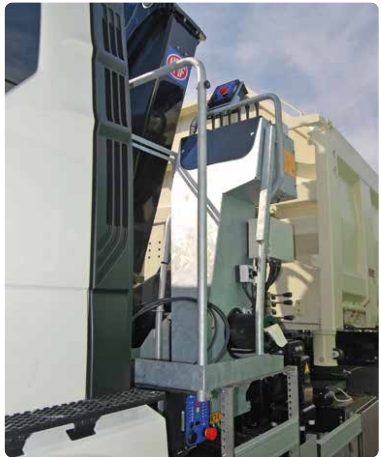
Werk zoveel mogelijk vanaf het plateau, want dan voel je wat de autolaadkraan doet.
