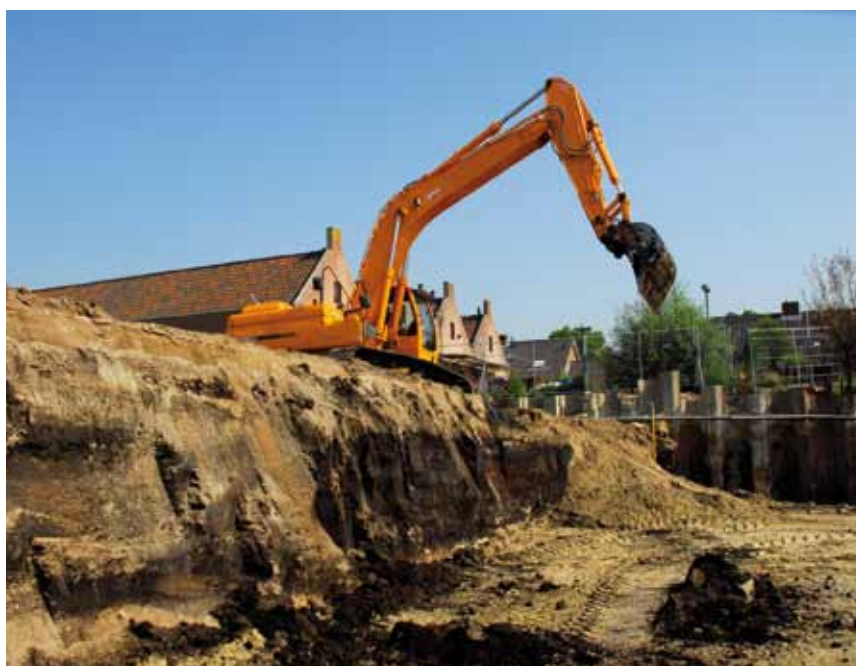
De afstand tussen de rand van het talud en de voorkant van de rupsen moet minstens even groot zijn als de diepte van de ingraving. Dat is hier duidelijk niet het geval!
