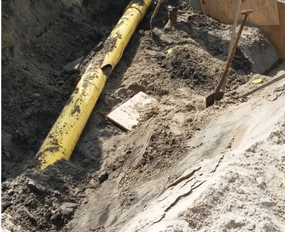
Figuur 1.1 Graafschade aan een gasleiding tijdens rioleringswerkzaamheden (Foto: Gertjan Steenberg)
